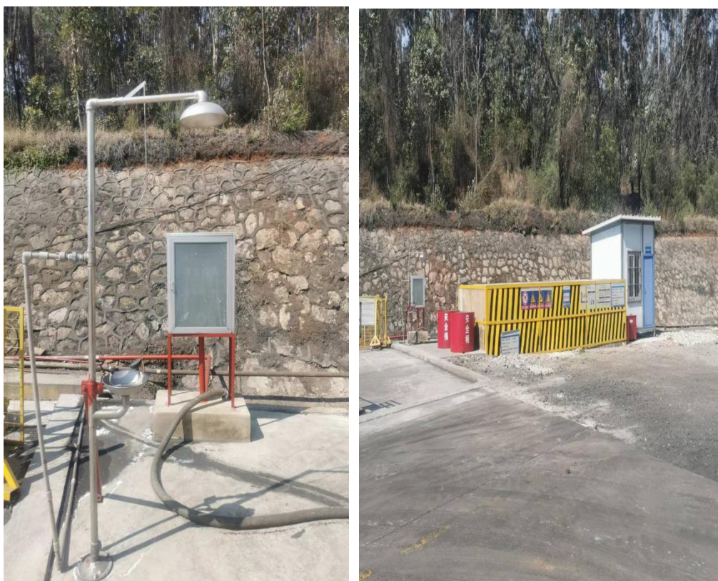
图 2-14 19 道喷淋设施及集装箱应急池
